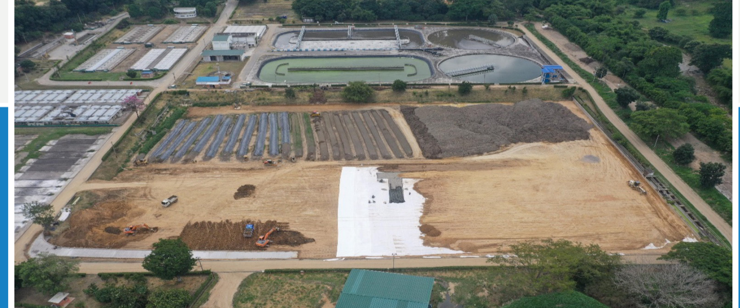
Instalación del material granular seleccionado sobre el geotextil de alto módulo FORTEX BX 760
